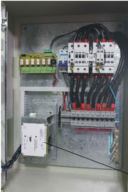
VISTA GENERAL DE LA BANDEJA DE POTENCIA
